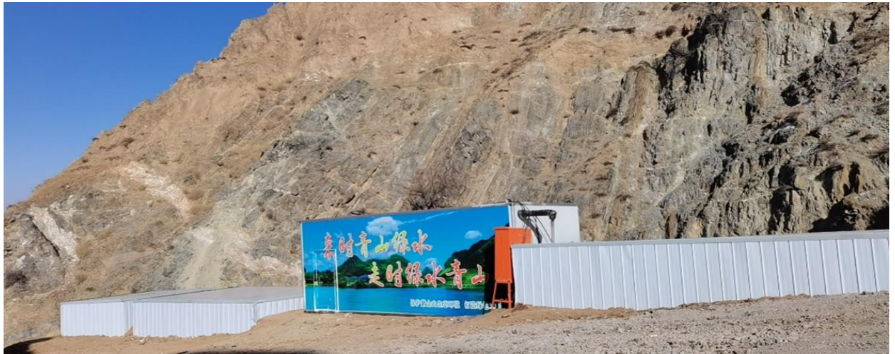
恒山隧道 1#斜井洞外污水处理设施
