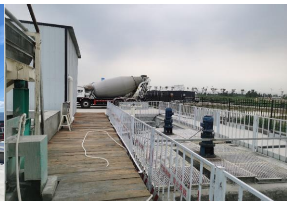
场站内回用沉淀池
